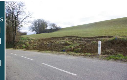
Effondrement de talus (Tarn)
